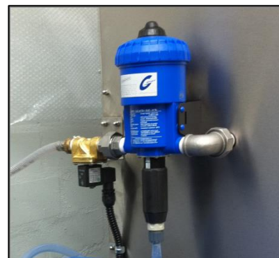
autom. Wassernachfüllung und Chemiedosierer
